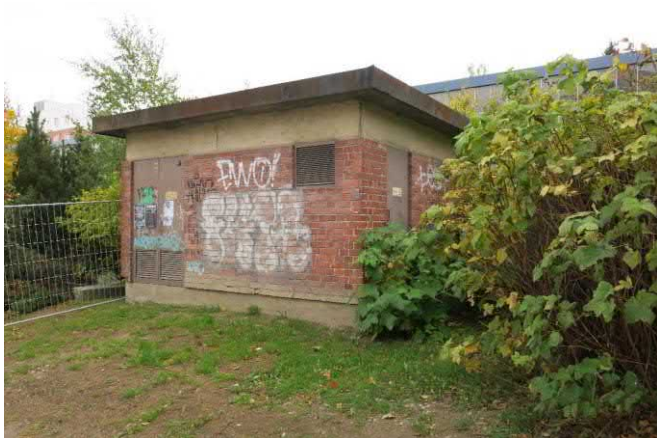
Takojankatu 8 kohdalla oleva muuntaja 2018.
